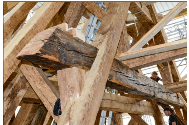
Cette poutre, qui a pu être réutilisée comme entrail intermédiaire, est un vestige de la charpente du XI e siècle.
